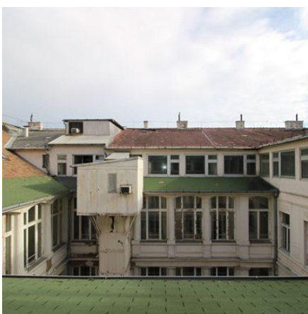
Utólagos lift gépház
